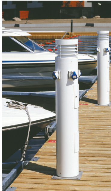
i-Valon laituriipollari jakaa sekä valoa että sähköä
